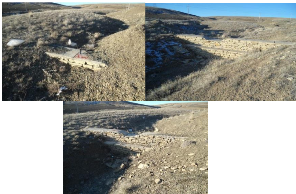
شکل ۵- برخی سازه‌های موجود در سطح حوزه آبخیز (به ترتیب از بالا سمت راست شکل الف: ساز حفاظتی سنگی سیمانی، بالا سمت چپ شکل ب: سازه سنگی سیمانی تنظیمی جریان و شکل ج: سازه سرریز تلاطم‌گیر-رسوب گیر جریان)
